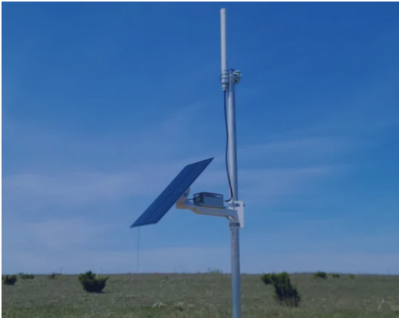
Przykładowa baza zasilana energią słoneczną
